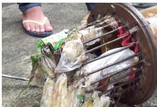
เมืองคอนขยะอุดท่อระบายน้ำ กรมชลประทานเร่งสูบน้ำออก
